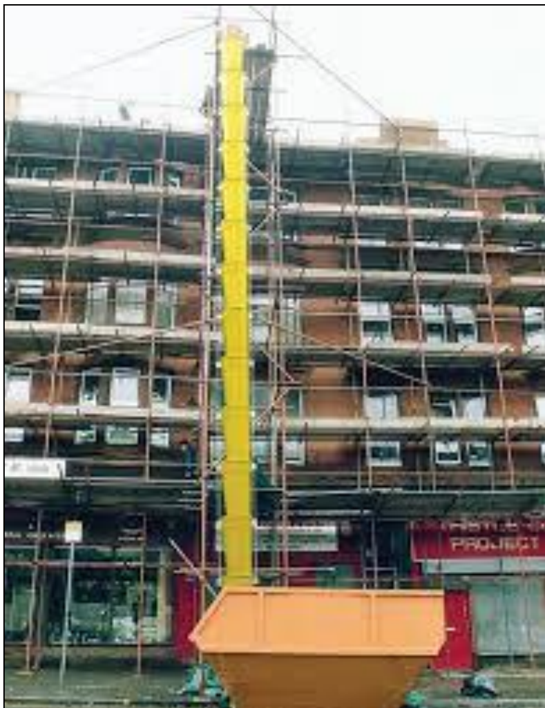
Εικόνα 9-7: Σωλήνας μεταφοράς σκουπιδιών (waste chute)
