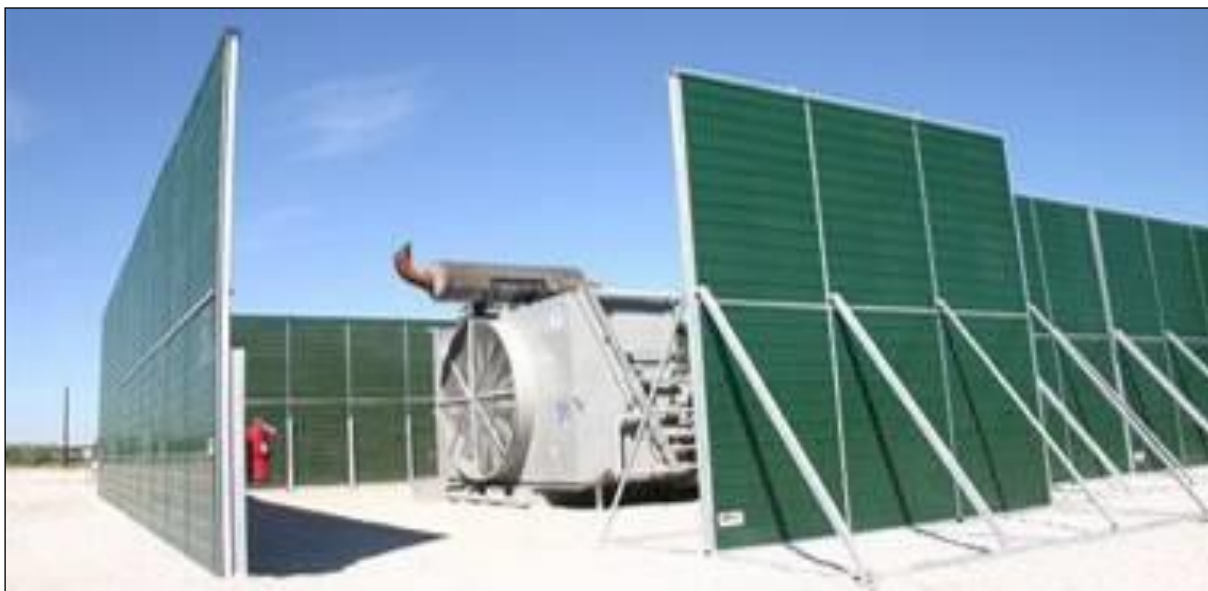
Εικόνα 9-1: Χρήση ηχοπετασμάτων σε σταθερές πηγές θορύβου
